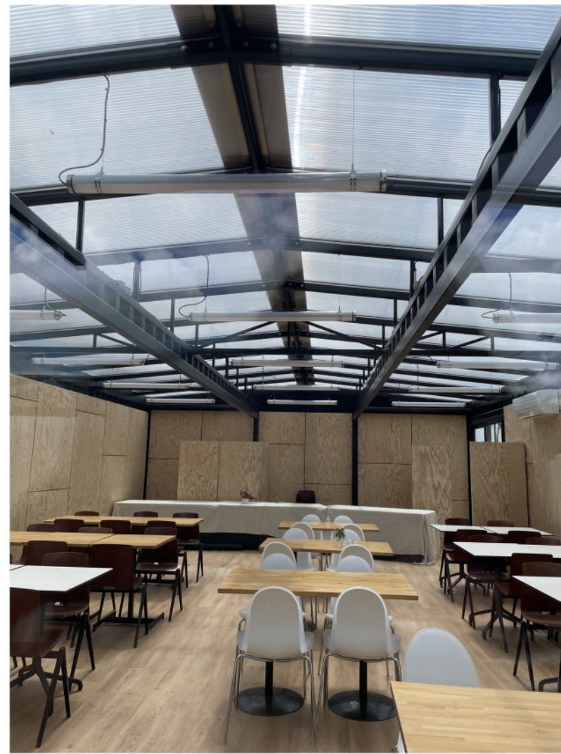
Sol parquet non conforme
